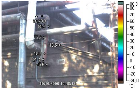
Detail termogramu potrubního systému:
