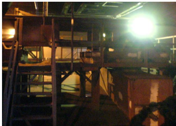
Obr. 2: Pohled od nové napínací stanice RD2
