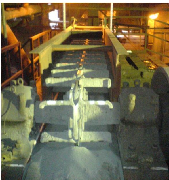
Obr. 1: Pohled od poháněcí stanice
